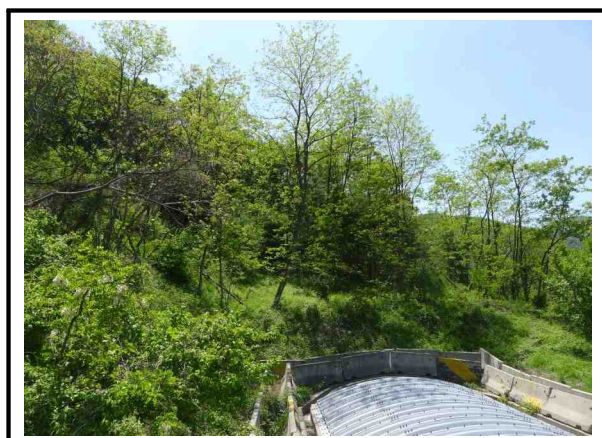
사진번호 70 종점부 사면 식생 활착 및 외관망도 - 수목 발달
