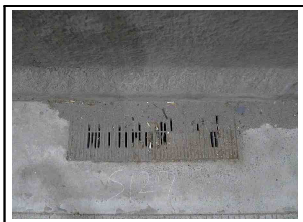
사진번호 48 집수구 S127 이물질 퇴적, 그레이팅 부식 외관망도 57-2
