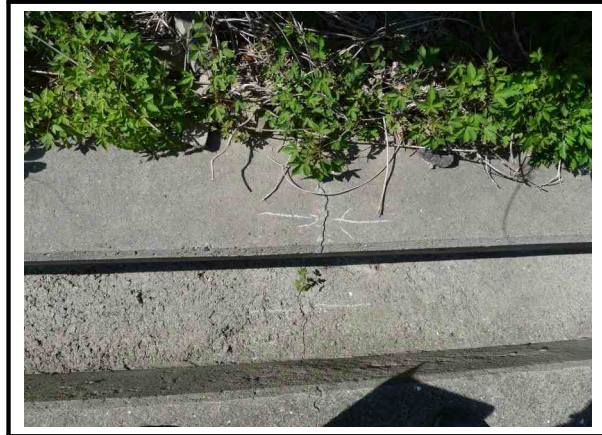
사진번호 74 종점부 도수로 외관망도 83-1 균열(0.3mm 이상)
