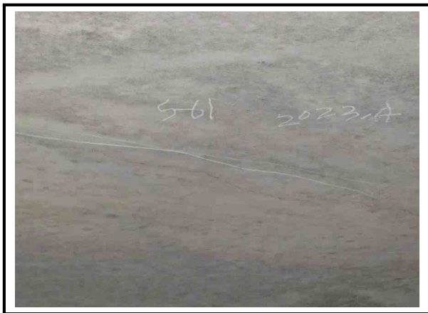
사진번호 19 천단부 S61 외관망도 27-4 균열(0.3mm 이상)
