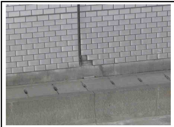
사진번호 33 측벽부 S57 좌측 타일탈락, 파손 외관망도 25-19
