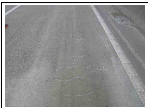
사진번호 59 포장부 S24 망상균열 외관망도 11-17
