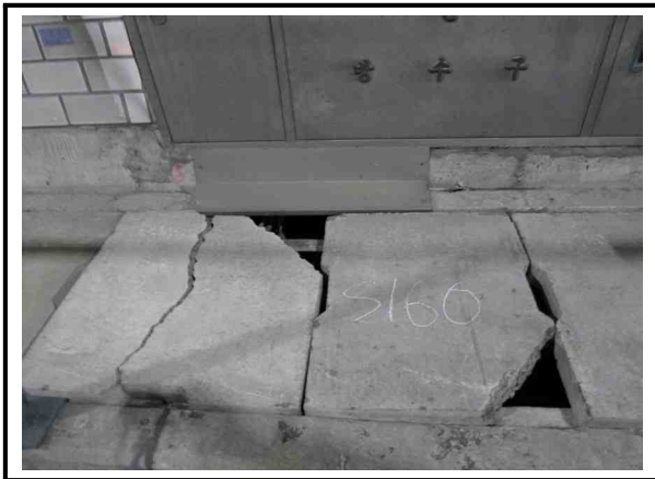
사진번호 55 공동구 S160 좌측 덮개 탈락 외관망도 72-2
