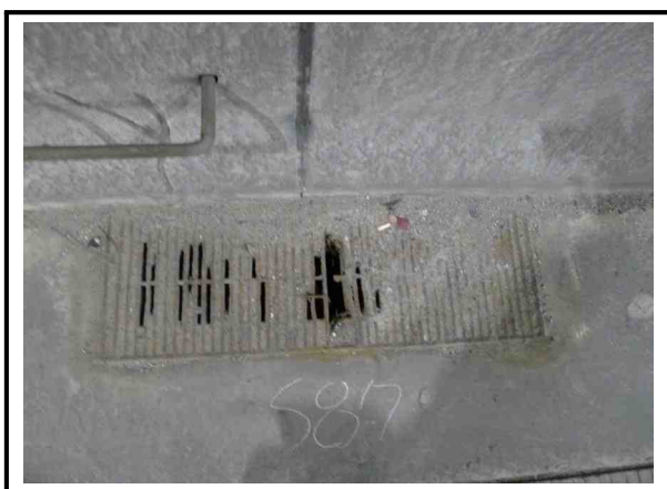
사진번호 47 집수구 S87 이물질 퇴적, 그레이팅 부식 외관망도 39-8
