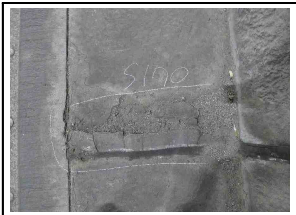
사진번호 43 측구 S170 파손 외관망도 76-6
