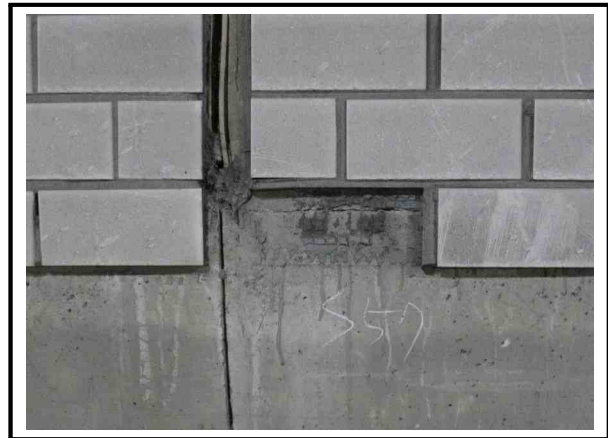
사진번호 32 측벽부 S57 우측 타일탈락, 파손 외관망도 26-1
