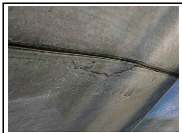
사진번호 22 천단부 S72(J72) 외관망도 32-14 시공이음부 박락
