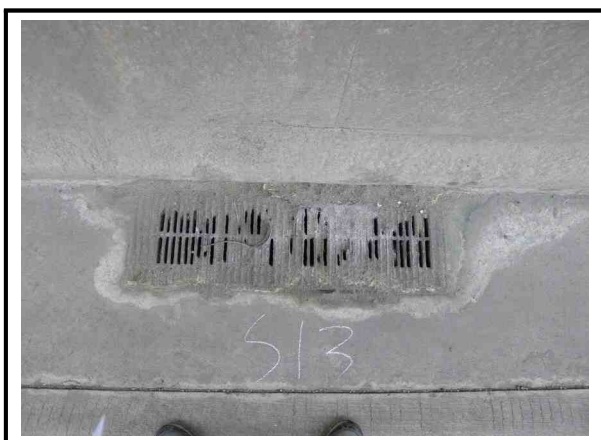
사진번호 45 집수구 S13 이물질 퇴적, 그레이팅 부식 외관망도 6-2
