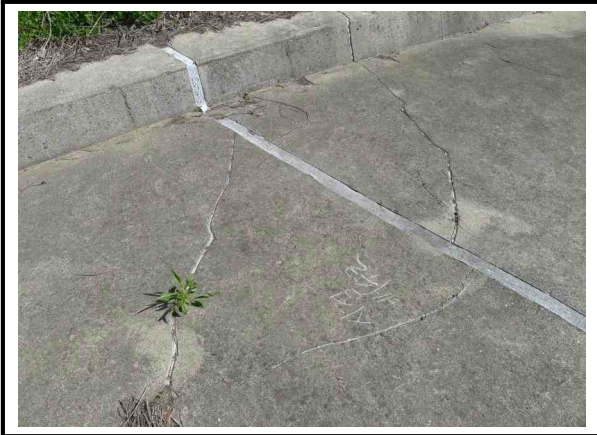
사진번호 73 시점부 소단배수로 외관망도 82-2 균열(0.3mm 이상)
