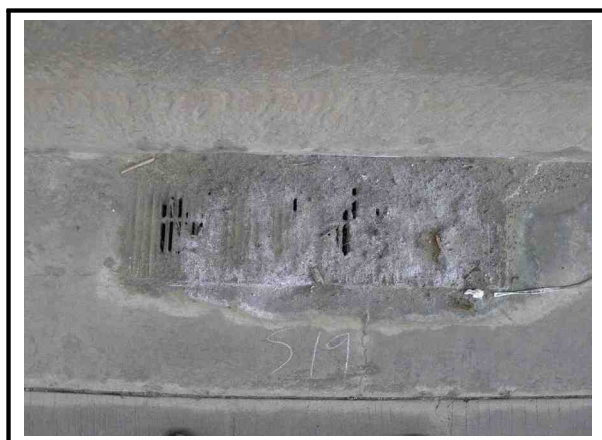
사진번호 46 집수구 S19 이물질 퇴적, 그레이팅 부식 외관망도 9-2
