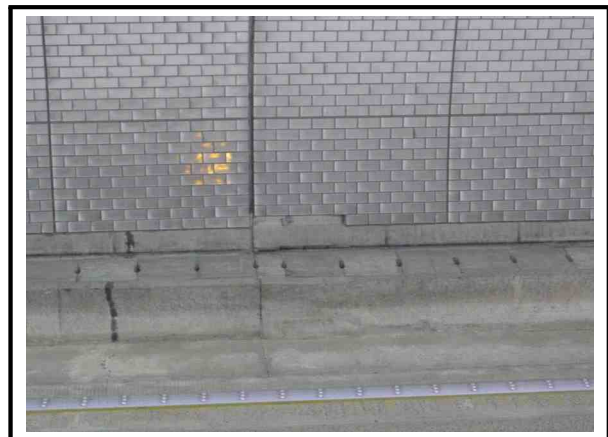
사진번호 36 측벽부 S142 좌측 타일탈락, 파손 외관망도 63-1
