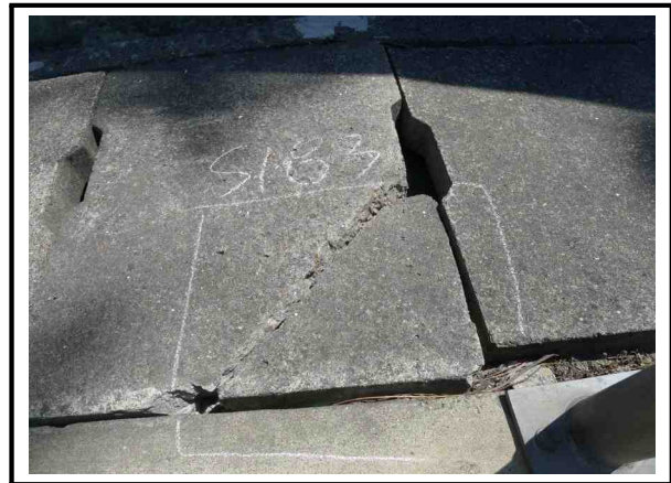
사진번호 56 공동구 S183 좌측 덮개 파손 외관망도 80-6
