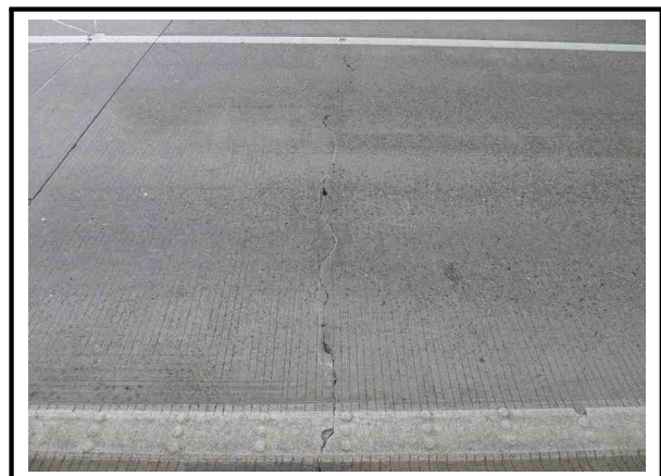
사진번호 58 포장부 S2 균열 외관망도 1-12
