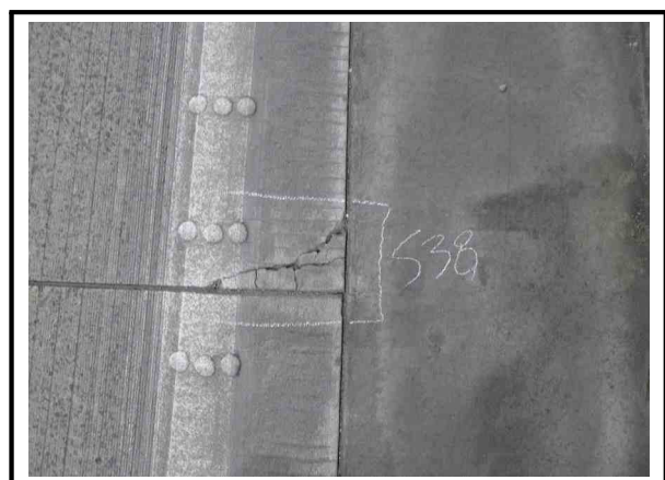
사진번호 60 포장부 S38 줄눈 주변 파손 외관망도 17-6
